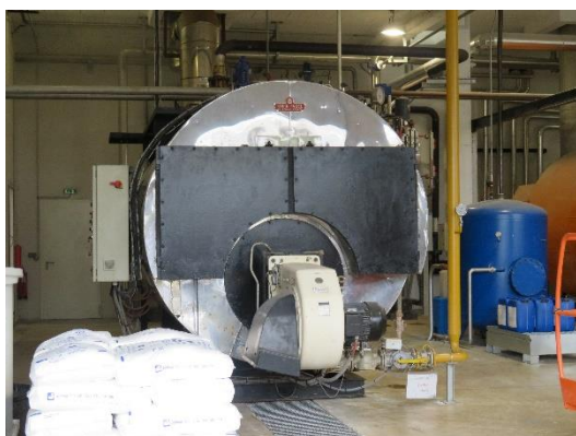
【図③ ボイラー】
